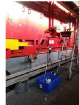
Photo 5 : Mesure de poussières - Ambiance Bâtiment Tri A
